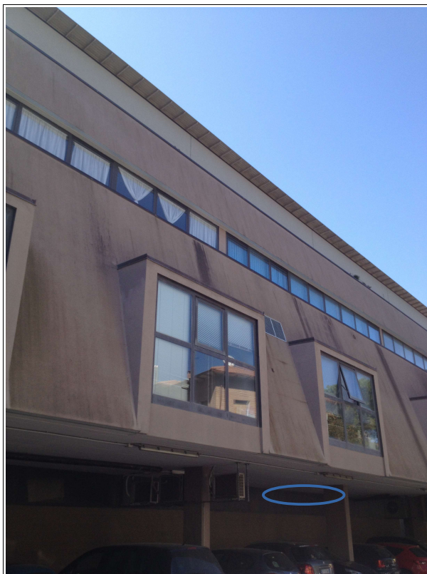
Fig. 3 – Area in cui verranno installate le due motocondensanti .
